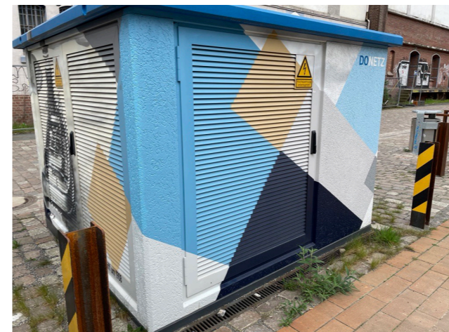
Digitale Ortsnetzstation in der Speicherstraße
