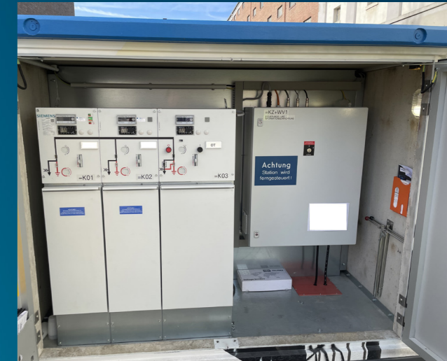
Mittelspannungsanlage mit Steuerschrank
